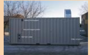
Das stationäre System - in einem 20' Container installiert
